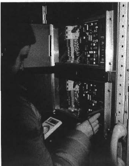
Fig 6 Mätningar i kontrolstativet för ERIGEN-systemet
