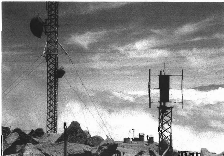
Fig 4 Utsikt över relästationen med vindturbinen i förgrunden. Bakom syns ventilationsrören för kraftaggregatet och ingången till containern
